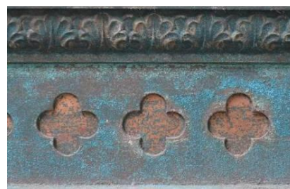
Fel blauwe corrosie
