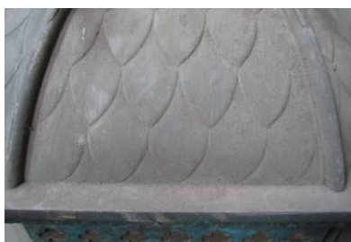
Egale laag corrosie
