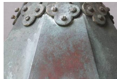
Onderliggende rode oxidelaag
