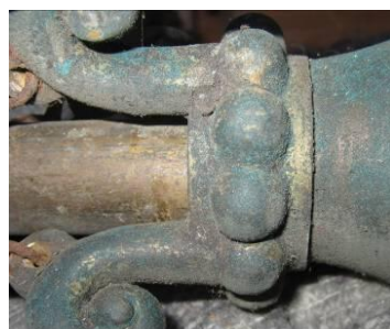
Ontbreken rode corrosie
